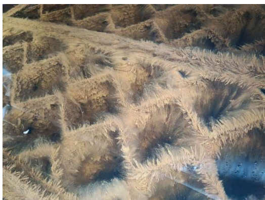
(写真-3) 嫌気ろ床接触ばっ気方式 KGN3型 10人槽
